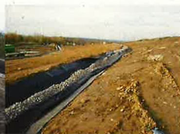
Drain de collecte des eaux
